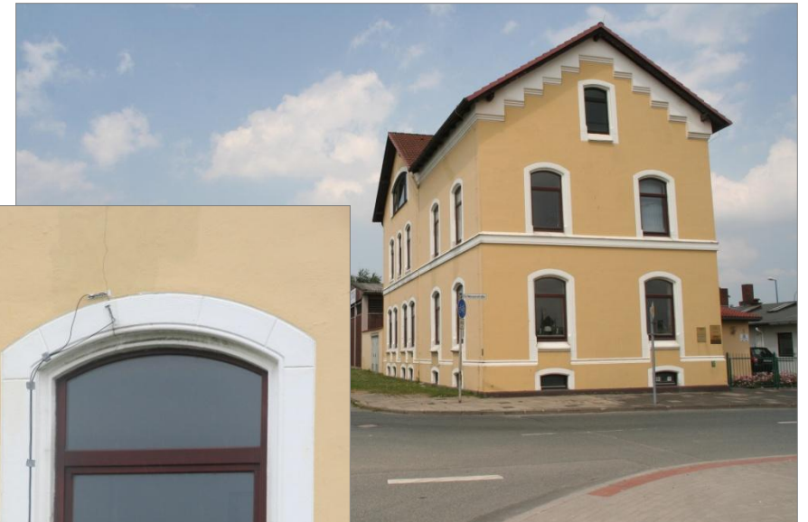
Rissensoren an verschiedenen Stellen am Gebäude
