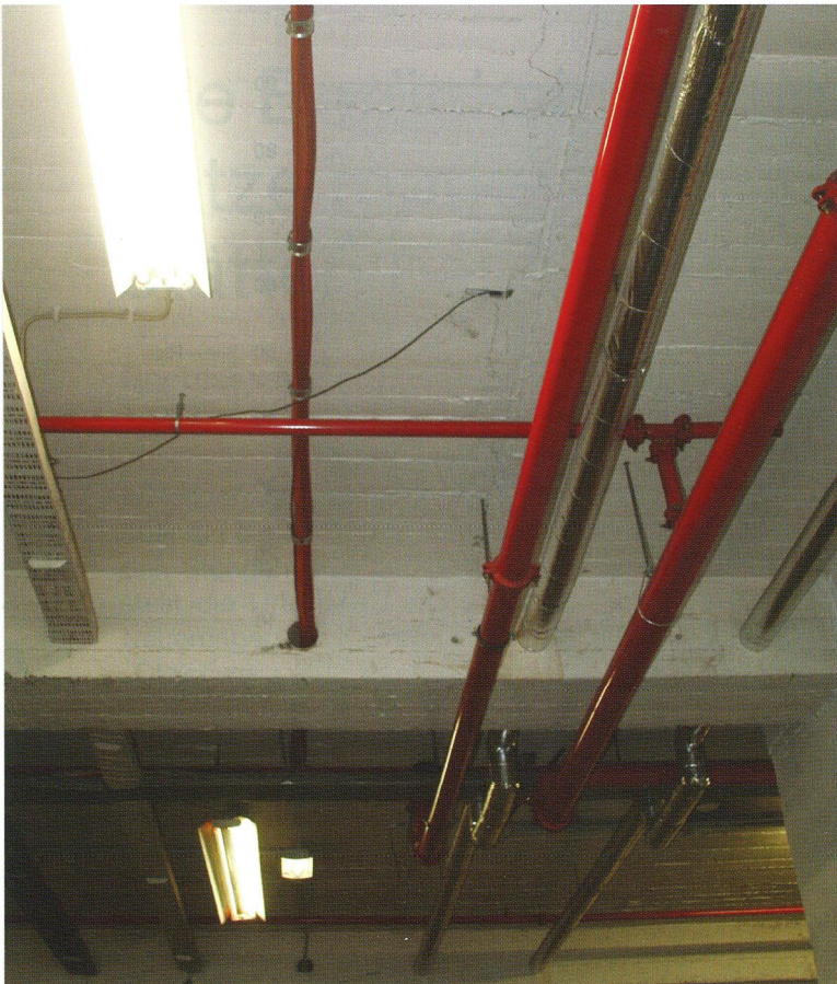
Abbildung 15: Digitaler Rissmonitor an der Decke
