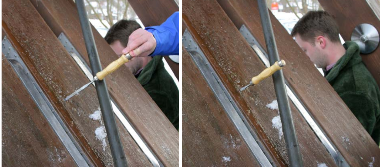
Abb. 4: Anzeichen für Fäulnis im Inneren (ca. 2-3 cm unterhalb der Oberfläche) einer Stielgruppe auf der Nord- bzw. Wetterseite der Essinger Brücke im Bereich der unteren Nagelplatten (Stechbeitel lässt sich mit geringem Kraftaufwand in die erweichte Holzsubstanz drücken).
