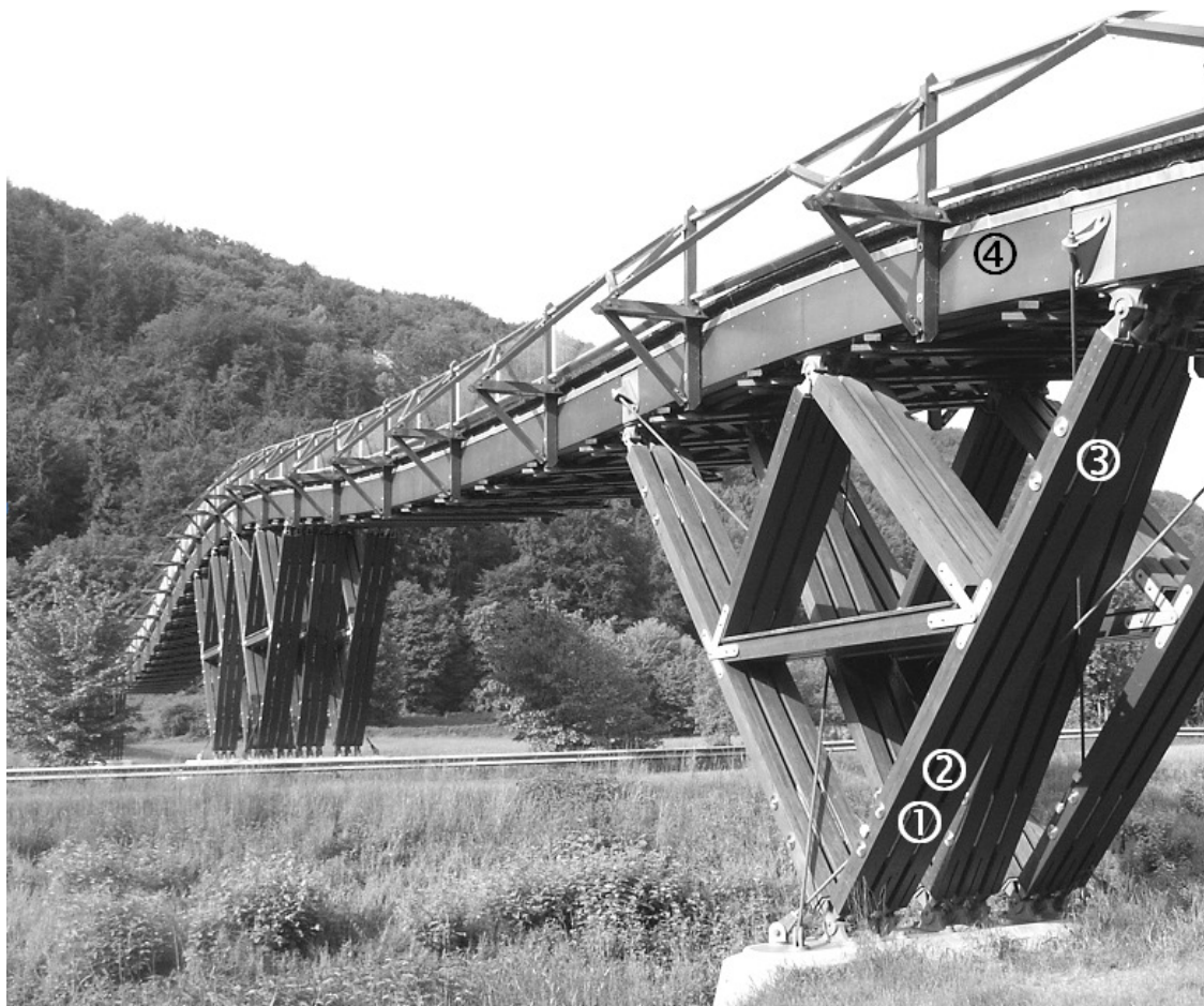
Abb. 10. Freitragende Fußgängerbrücke in Essing, aus Fichten-Brettschichtholz: ① Untere Nagelplatten, ② Bereich oberhalb der unteren Nagelplatten, ③ obere Nagelplatten, ④ mit Sperrholz bekleidete Zugbänder.
