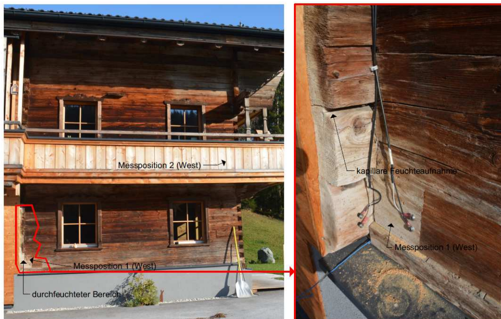
Abbildung 46: Kritischer Bereich bei Schrottvorköpfen an der Westfassade durch kapillare Wasseraufnahme
