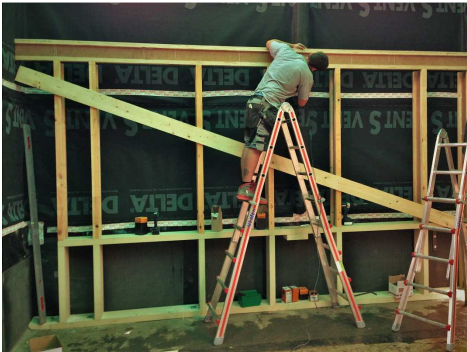
Abbildung 41: Montage der Unterkonstruktion welche im Sockelbereich aus Purenit ausgeführt wurde (Foto: DI Hans Peter Gruber)
