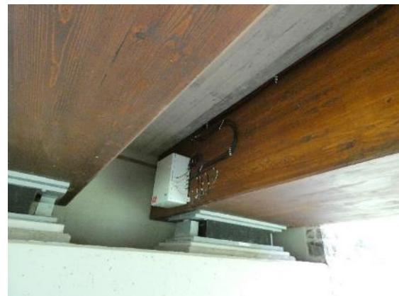
Installationskasten und Messstelle MS1
