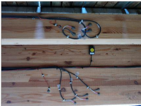
unten: Messstelle MS1; oben: Messstelle MS2
